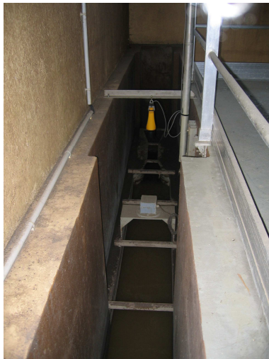
CANAL DE COMPTAGE EN ENTREE
