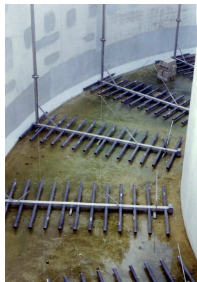
RAMPES D'INSUFFLATION D'AIR
