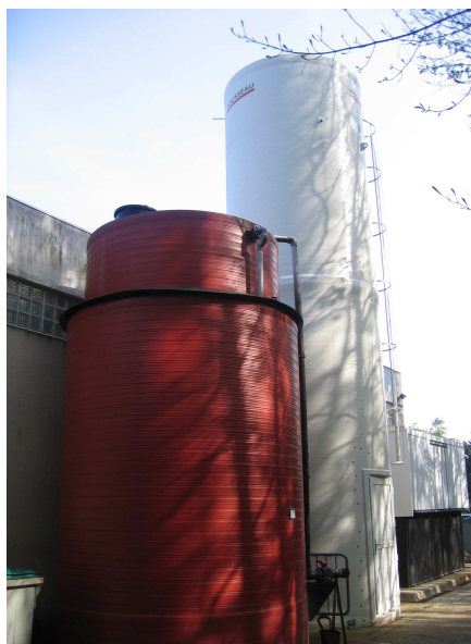
Silos à réactifs
